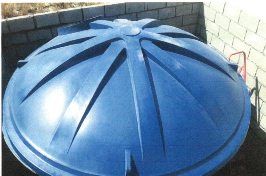
Foto 08 - RESERVATÓRIO DE POLIETILENO 10.000 LITROS
